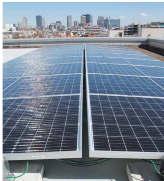
10.8 kW | 東京電力技術開発センター
