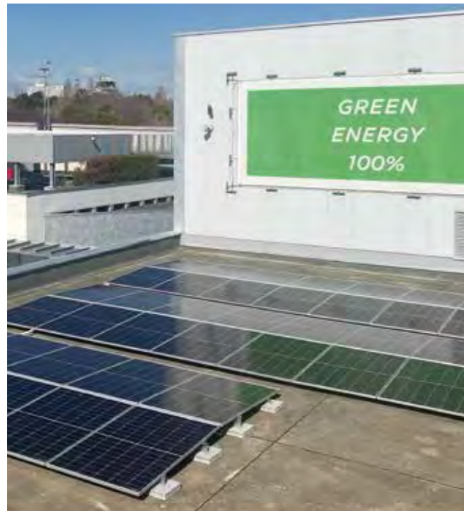
131.97kW | 東急不動産(もりのみやキューズモール)
