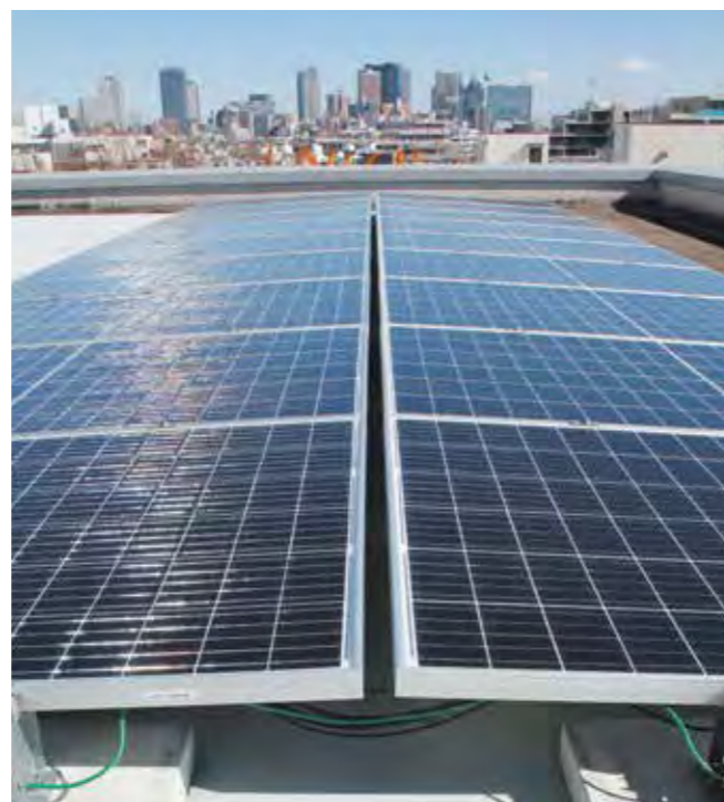
10.8 kW | 東京電力技術開発センター
