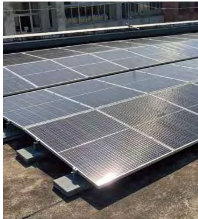
95.04kW | 千葉市内小学校
