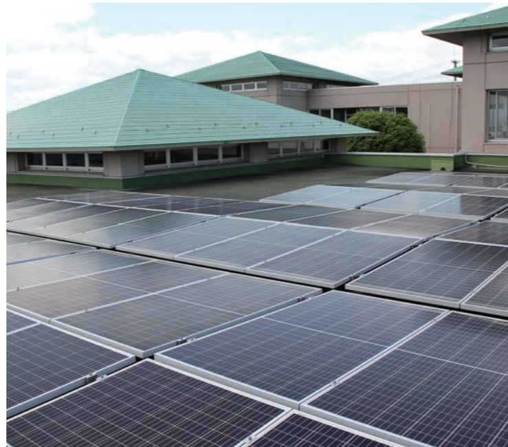
<アンカー固定架台> 公共施設：美里町健康福祉センター (システム容量 38.4kW)
