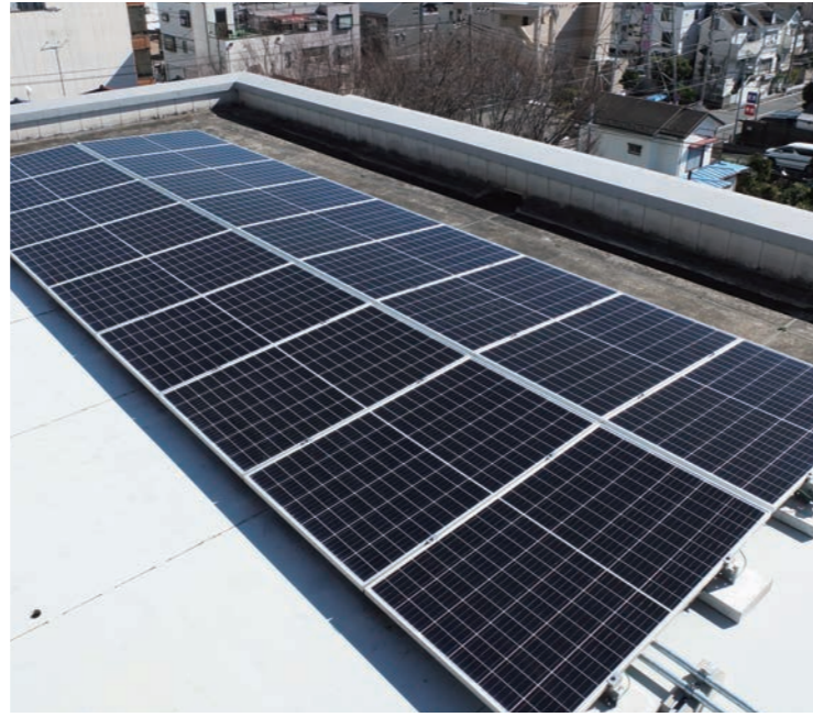
<X-3> 一般企業：東京電力技術開発センター (システム容量 9.9kW)
