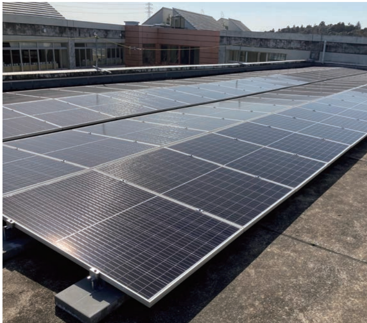
<X-3> 公共施設：千葉市内小学校 (システム容量 95.0kW)
