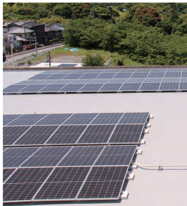
72.96kW | 三重県桑名市
