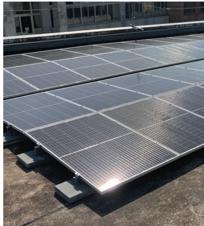
95.04kW | 千葉市内小学校
