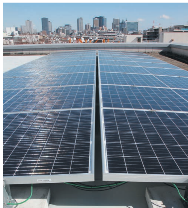
10.8kW | 東京電力技術開発センター
