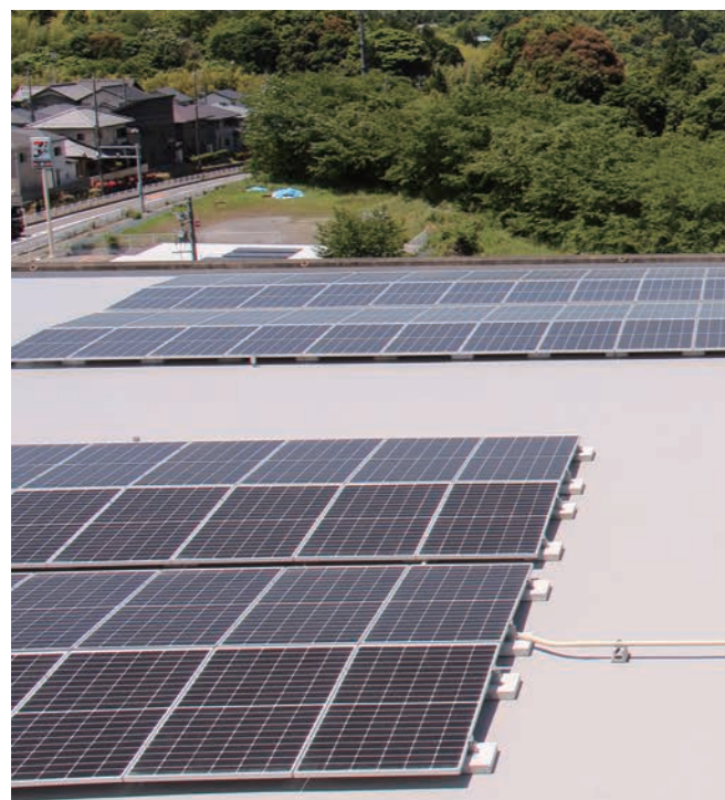
72.96kW | 三重県桑名市
